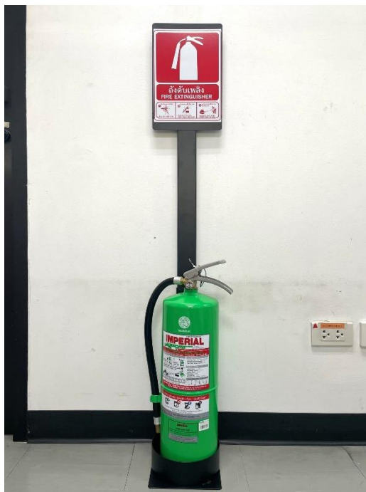
รูปที่ 24 ถังดับเพลิงของศูนย์ทดสอบชีววัสดุ เป็นประเภท Low Water Pressure สามารถดับประเภทของไฟชนิด A B C และ K ได้
