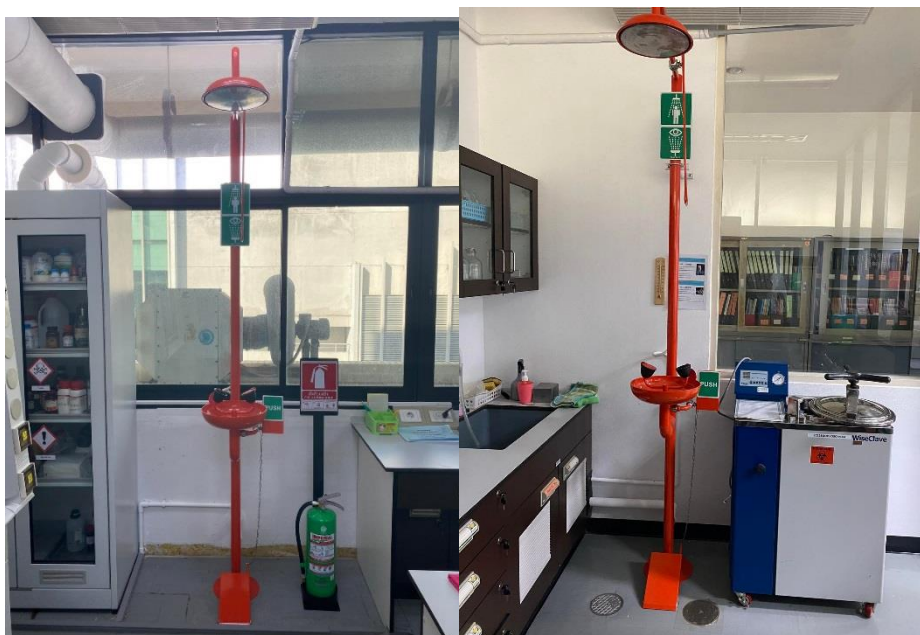
รูปที่ 12 เครื่องล้างตา-ล้างตัวฉุกเฉิน (Emergency Shower and Eye Wash) ติดตั้งบริเวณริมหน้าต่างห้องปฏิบัติการกลาง (ภาพทางซ้ายมือ) และภายในห้องปฏิบัติการ BSL 2 ห้องเพาะเลี้ยงเชื้อจุลชีพ (ภาพทางขวามือ) ศูนย์ทดสอบชีววัสดุ
