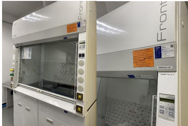
รูปที่ 23 ตู้อุดไอระเหยสำหรับปฏิบัติงานกับของเสียอันตราย 332028001842 วจ.56
